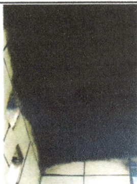
Foto 3: Tejado de la cocina en condiciones inadecuadas.
