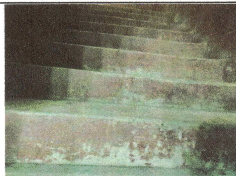
Foto 6: Falta de pintura en las gradas y paredes.
