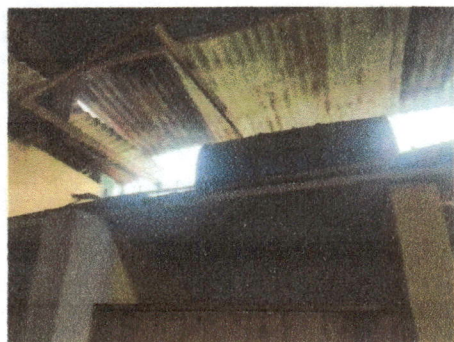
Foto1: Falta de sistema eléctrico en los baños.
