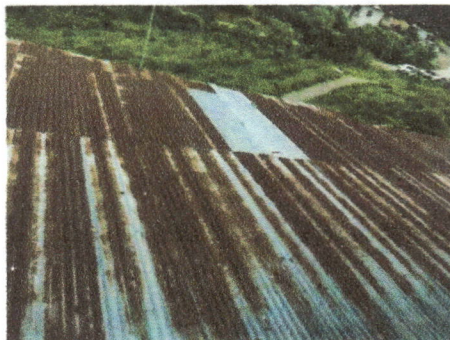
Foto 2: Tejado del patio y aulas en malas condiciones.
