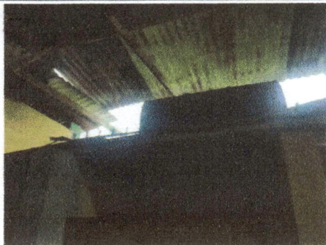
Foto1: Tejado de los baños en malas condiciones.
