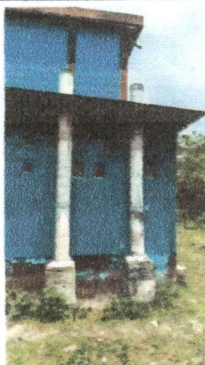
Foto 3: Chimeneas en mal estado.
