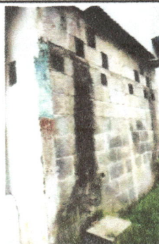
Foto 4: paredes de la cocina en malas condiciones.
